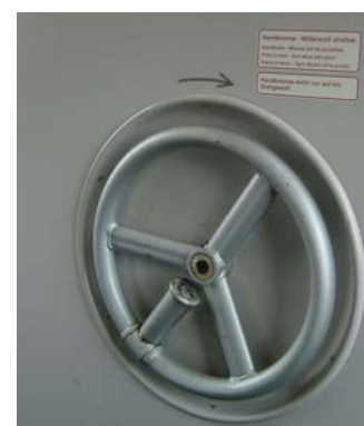
Abbildung 37: Feststellbremseinrichtungen im Eingangsbereich
