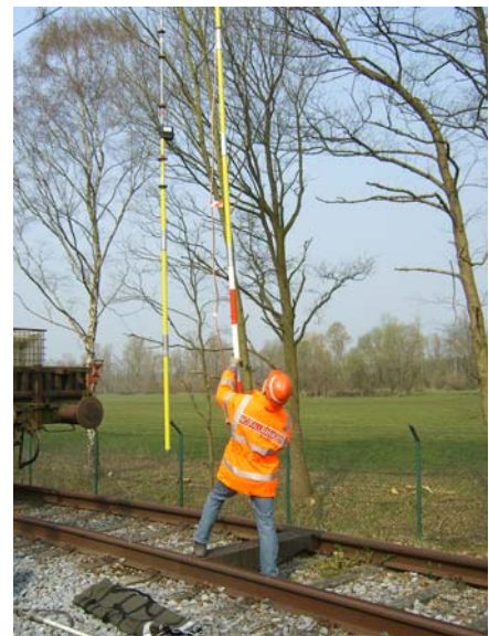
Abbildung 11: Für die Bahnerdung im Ereignisfall ist der Notfallmanager verantwortlich...
