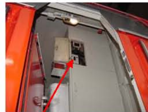
Hauptschalter bei BR 218 im Einstiegsbereich (rechter Einstieg im Führerstand 1)
