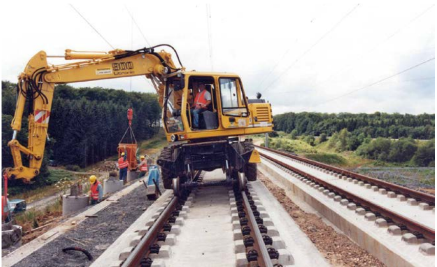
Abb. 7-10: Auf dem Gleisfahrwerk liegt die Kippkante des Baggers wesentlich weiter innen als auf dem Straßenfahrwerk. Die Gleisüberhöhung im Bogen verringert die Standsicherheit.
