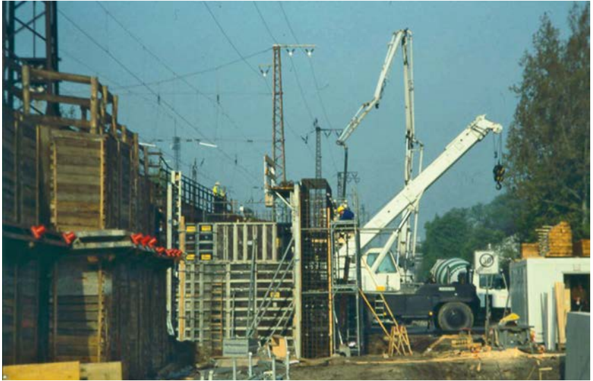
Abb. 1-2: Bei Mobilkran und Betonpumpe besteht hier die Gefahr der Annäherung an die auf den Fahrleitungsmasten geführte Speiseleitung.
