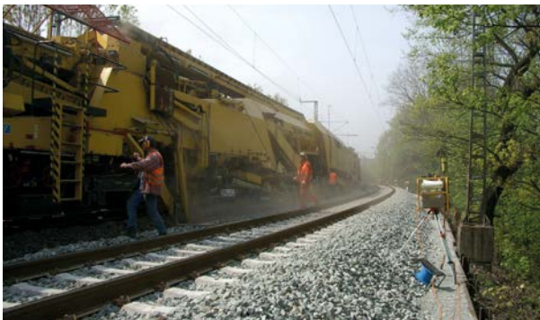
Abb. 8-1: Arbeitsplätze auf der Mittelkernseite einer Planumsverbesserungs- maschine.
