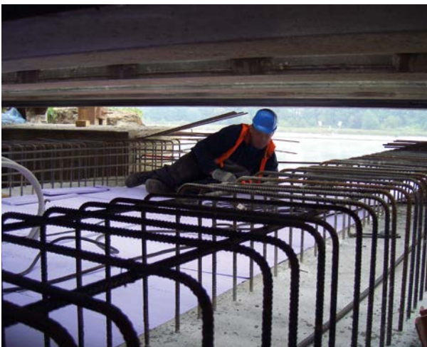
Abb. 12-9: Bei unzureichendem Arbeitsraum kann die Tunneldecke nicht fachgerecht hergestellt werden und Betonieren, Oberflächenbehandlung und Abdichten können Anlass geben, die Hilfsbrücke zu betreten. Warnwesten sind geschlossen zu tragen.
