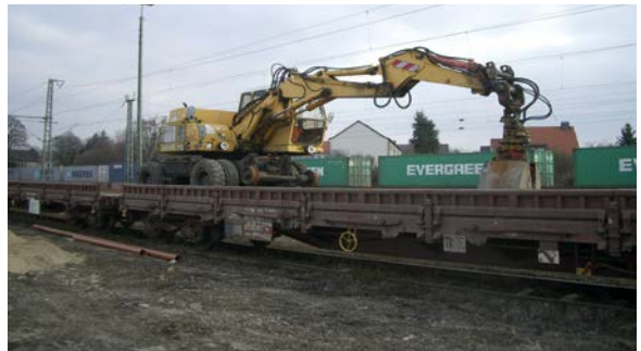
Abb. 4-10: Maschinen und Geräte, die auf Eisenbahnwagen unter Oberleitung eingesetzt werden, müssen bahngeerdet sein.
