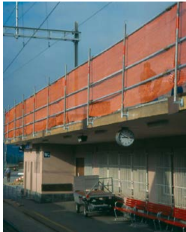
Abb. 4-9: Die Abschränkung für Arbeiten auf einem Bahnsteigdach neben einer Oberleitung soll die Gefahr ausschließen, den Schutzabstand zur Oberleitung unbeabsichtigt zu unterschreiten.
