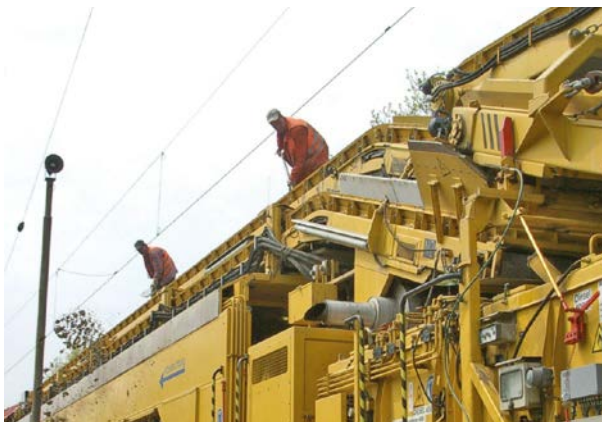
Abb. 8-9: Bei Arbeiten an hochliegenden Förderbändern muss die Oberleitung ausgeschaltet und bahngeerdet sein. Zum Schutz vor Absturz ist Anseilschutz einzusetzen.
