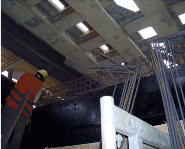
Abb. 12-8: Bei den Bewehrungsarbeiten für die Tunnelwände besteht die Gefahr, dass Bewehrungsseisen unbeabsichtigt durch die Hilfsbrücke in den Gleisbereich geraten.
