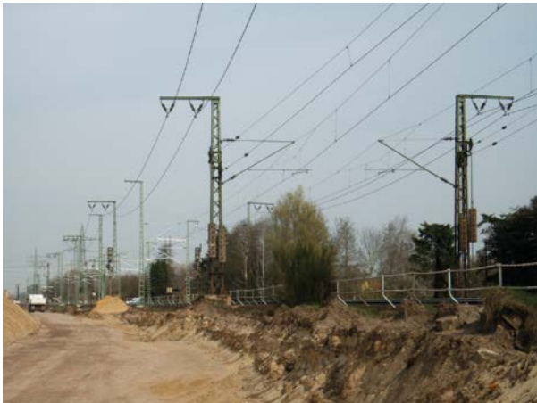
Abb. 4-1: Oberleitungsanlage mit Abspannleitungen sowie Speiseleitung auf den Oberleitungsmasten.
