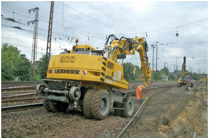
Abb. 7-24: Bei unebenem Gelände kann der Schutzabstand zur Fahrleitung durch die Längsneigung des Unterwagens unterschritten werden. Warnkleidung ist geschlossen zu tragen.
