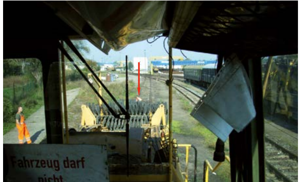
Abb. 9-5: Sichteinschränkung im rückwärtigen Bereich einer Schotterplaniermaschine. Die gerade erkennbare Person in gebückter Haltung befindet sich 15 m vor der Pufferbohle.
