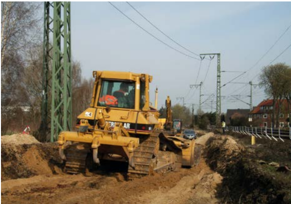
Abb. 12-5: Bei Erdbauarbeiten in der Nähe des Gleisbe- reichs unterhalb von Fahrleitungen muss geprüft werden, ob Gefahr besteht, dass Maschinen oder Fahr- zeuge den Schutzab- stand unterschreiten.
