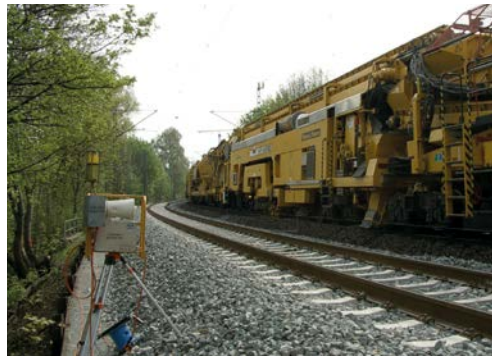
Abb. 2-12: Automatisches Warnsystem auf der Feldseite des Betriebsgleises zur Sicherung einer Planungsverbesserungsmaschine, deren Maschinenwarnanlage von der feldseitigen Warnsystemzentrale angesteuert wird.
