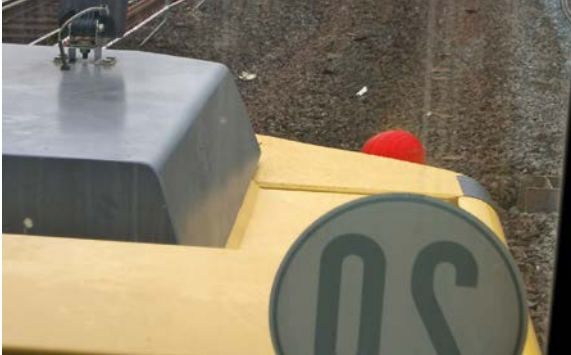
Abb. 7-4: Sicht des Baggerführers aus dem rückseitigen Kabinenfenster auf einen Beschäftigten, der etwa 0,5 m hinter dem Bagger steht: nur ein Teil des Schutzhelms ist sichtbar.
