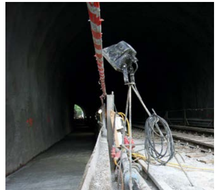
Abb. 12-3: Der Bereich hinter der Festen Absperrung darf nicht zur Materiallagerung benutzt werden. Wenn der Zugriff z. B. auf Baustellen-Versorgungsleitungen notwendig ist, ist auch für kurzzeitige Tätigkeiten eine Sicherung erforderlich.
