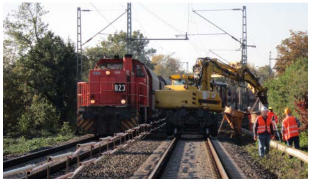
Abb. 2-5: Einsatz einer Festen Absperrung im Mittelkern bei 4 m Gleisabstand (80 km/h im Nachbargleis, Lü während der Arbeiten ausgeschlossen).
